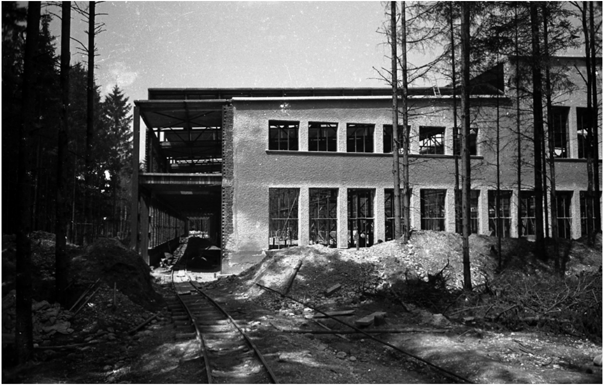
Die Bauarbeiten an der Halle I im Sommer 1941. Die Halle I unterschied sich von allen anderen Hallen durch ihre besondere Architektur. [Archiv ECS]
